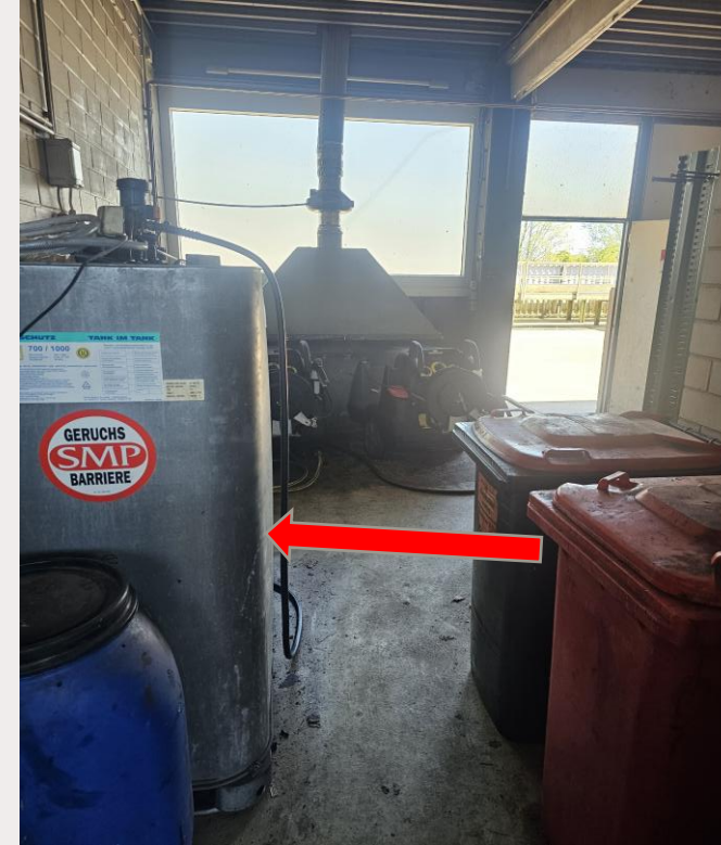
Heizöltank zum betreiben Hochdruckreiniger im Hochdruckreiniger Geräteraum (Heißwasser Hochdruckreiniger mit Zündquelle)
