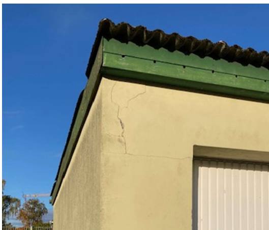
Typische Rissbildung im Mauerwerk
