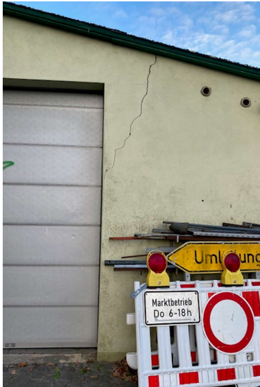
Risse im Mauerwerk
